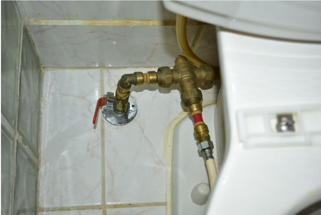
A well-plumbed bidet
